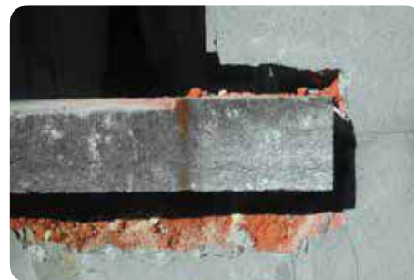
Vrijmaken van de boven-, zij- en onderkant van de dorpel © CDR Construction
