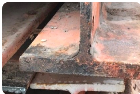
Dégradation du revêtement d'origine © Gebruikte bouwmaterialen Weert
