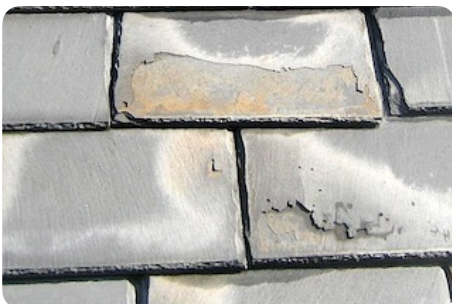
Efflorescences et délamination © nachi.org
